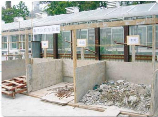
Construction waste is sorted for reuse or recycle. 建築廢料會被分類，以便再用或循環再造。
