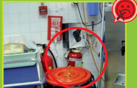
滅火筒被放置於垃圾桶後方，不易取用。
