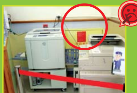
消防喉被影印機遮擋，妨礙使用。
